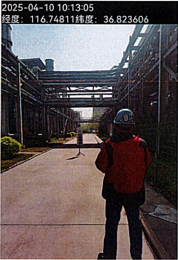
2#燃气轮机组排气筒（DA002）
